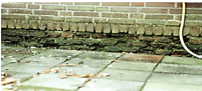
Afh. 4. De verweerde buitenmuur van de kelder
